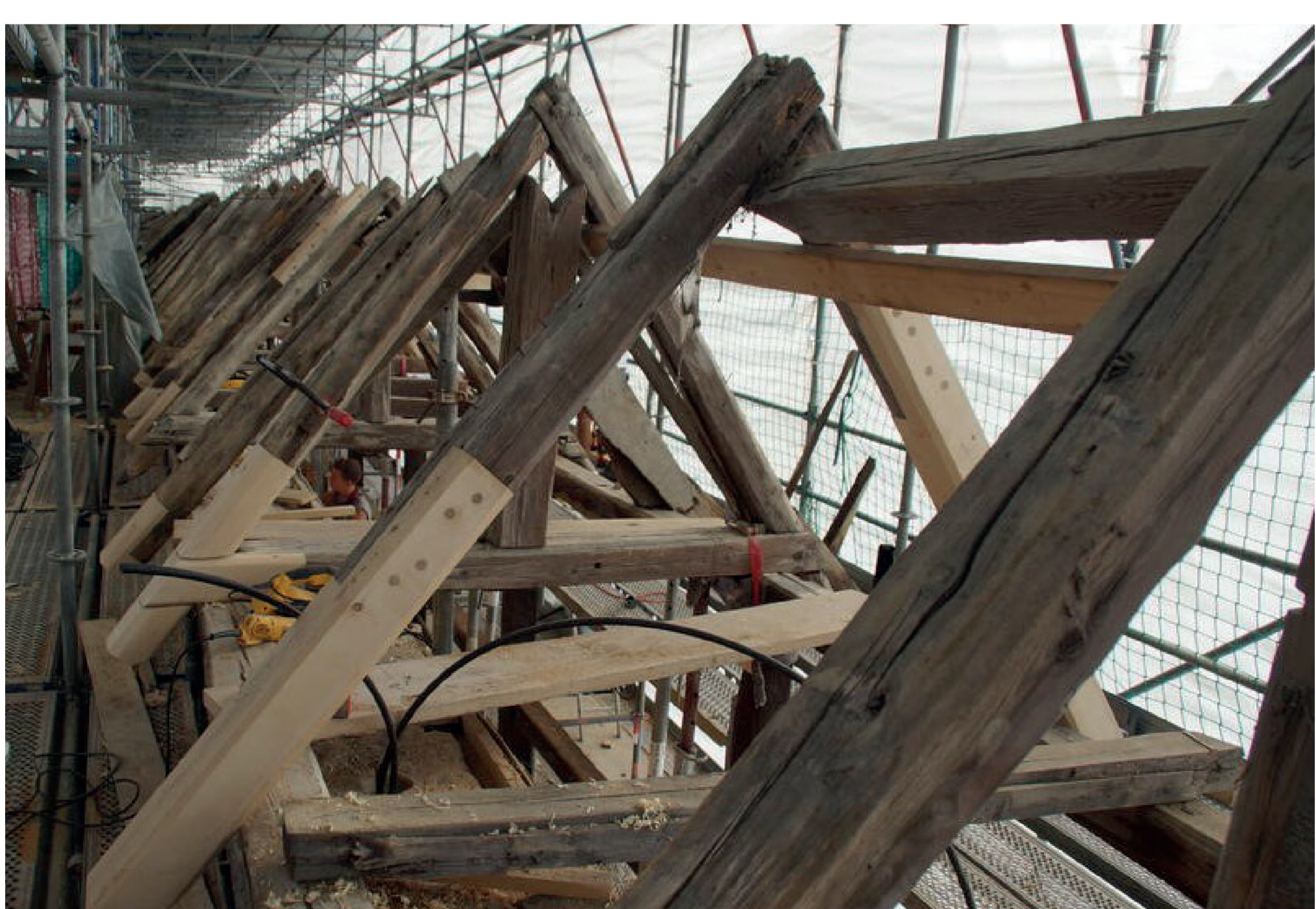
Instandsetzung des ältesten überdachten Wehrganges in Deutschland aus dem 14. Jahrhundert an der Kohlschanze, 2019
